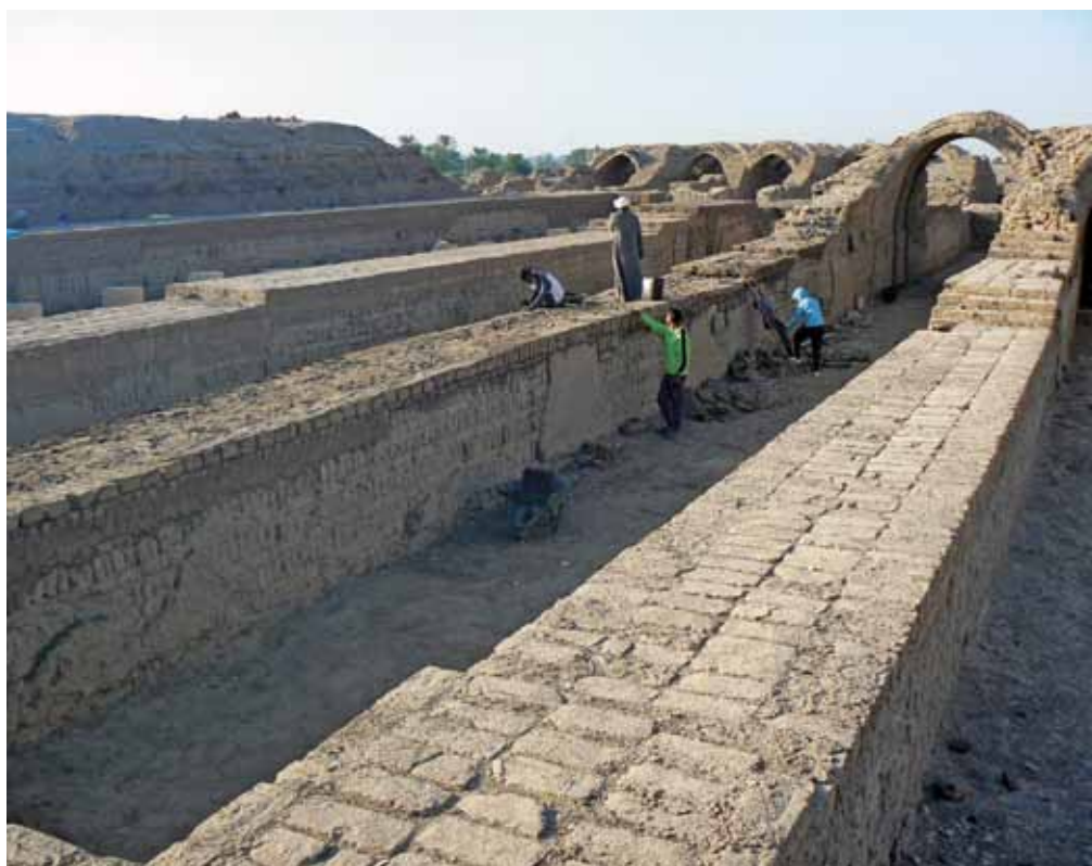
A.- RAMESSEUM. SECTEUR STI. Restauration des murs en brique crue des celliers du temple. (Cliché © Christian Leblanc).
